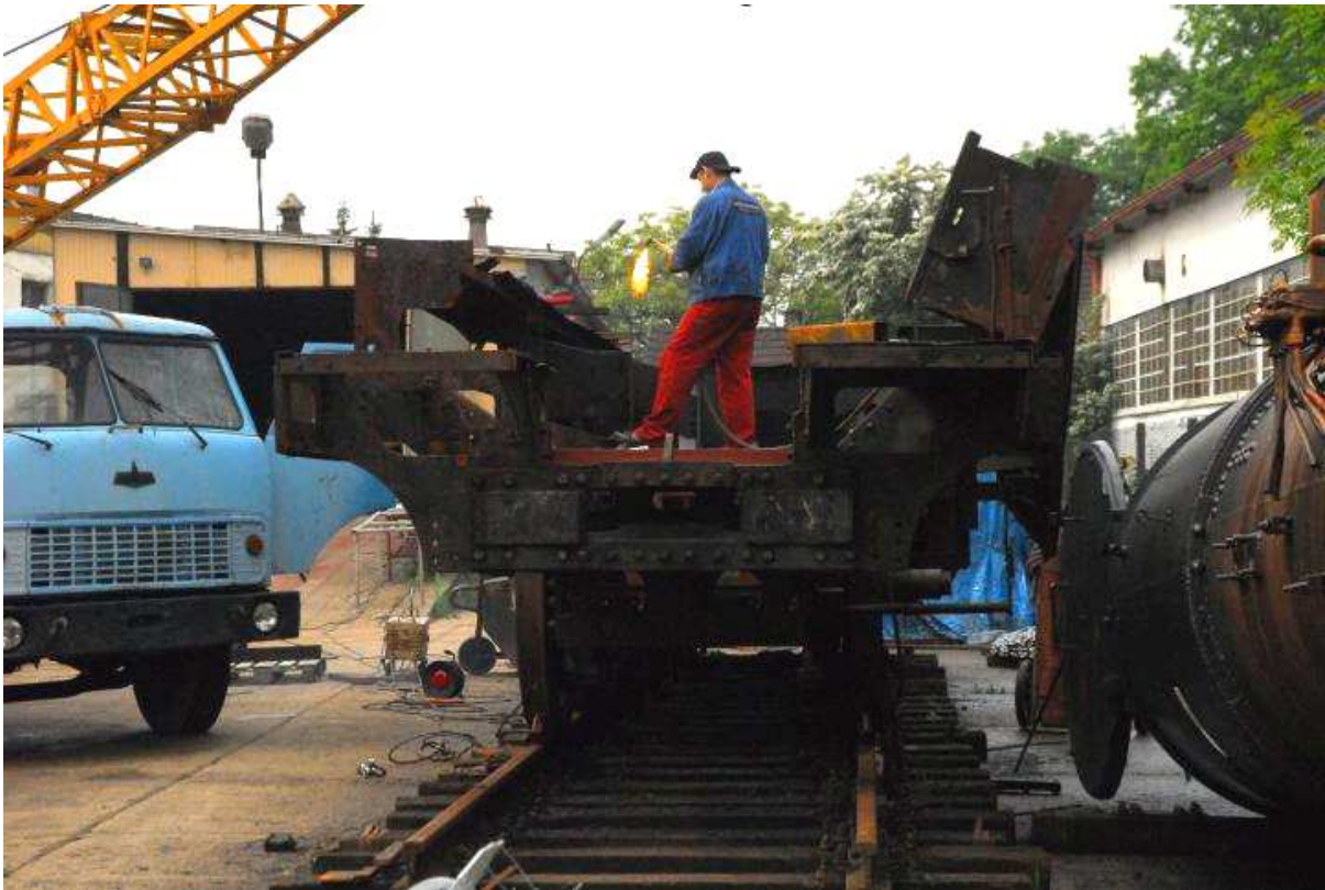
Wycinanie elementów z ostoi parowozu Ty2-1035 – 2009 r. (prawdopodobnie w Długołęce pod Wrocławiem).
